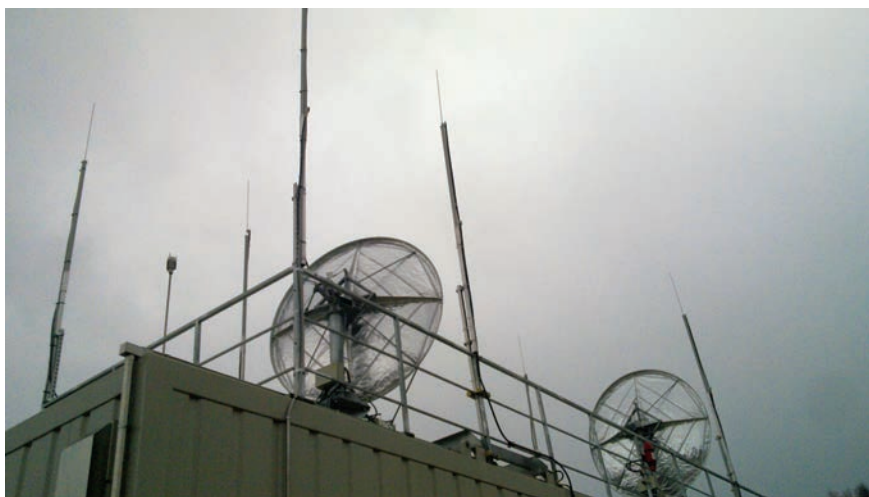
Рис. 4. Защита системы телеуправления и спутниковой связи на КС «Портовая» с помощью системы DEHNconductor с безопасным токоотводом HVI®
