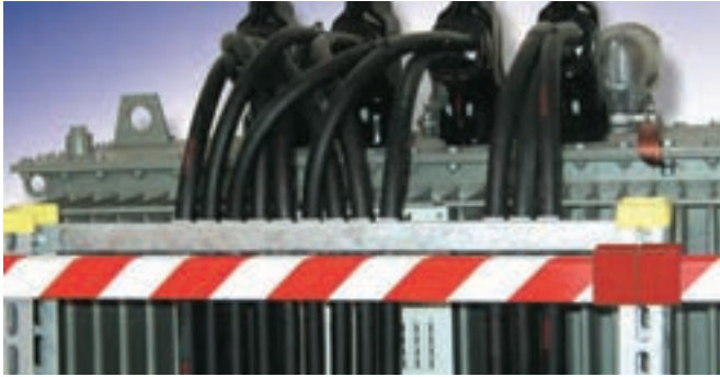
变压器站内的防护栏
