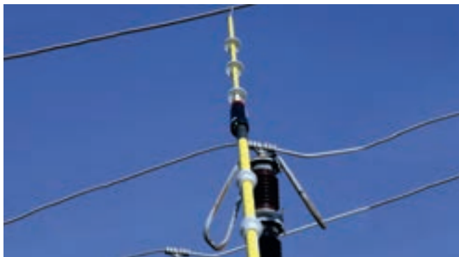
在一个110 kV户外站中使用PHE III电压探测器
