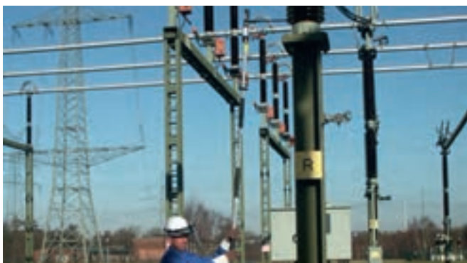
在户外配电站使用ASP非接触式电压探测器
