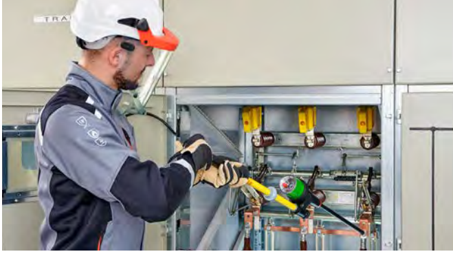
Einpoliger Phasenvergleichler PHV I an einer Schaltanlage.
