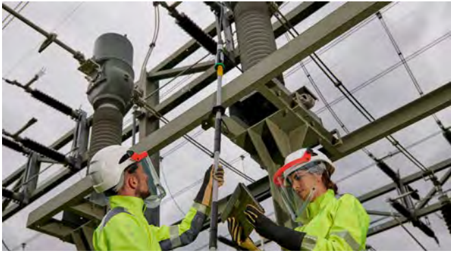
Abstands-Spannungsprüfer ASP in einer Freiluftschaltanlage.
