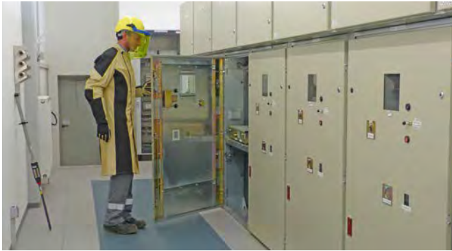
Schaltraum mit ausgelegter Isoliermatte.
