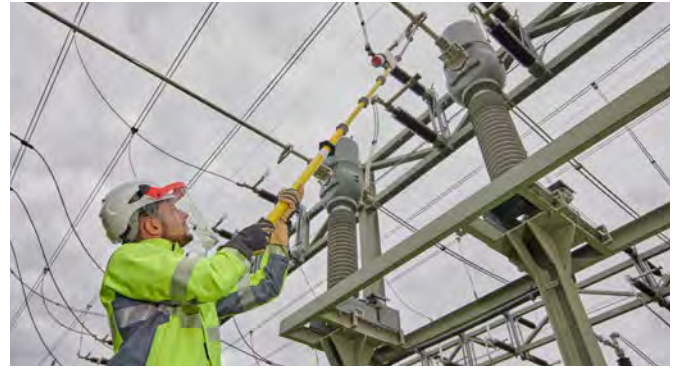
Spannungsprüfer PHE4 an einer Freiluftstation 110 kV.
