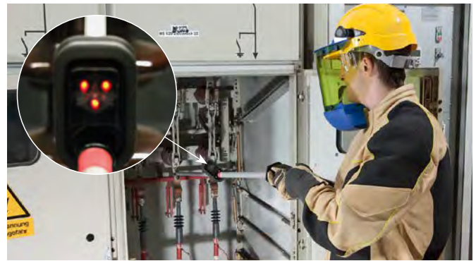
Spannungsprüfer PHG II an einer typgeprüften Schaltanlage.
