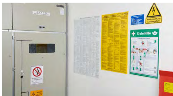
Warn- und Hinweisschilder in einer elektrischen Anlage.
