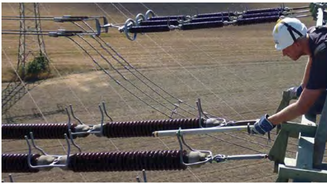
Hochspannungsanzeiger an einer 110 kV-Freileitung.
