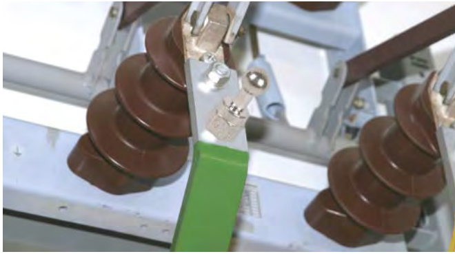
Kugelfestpunkt gerade, montiert auf einer Sammelschiene.
