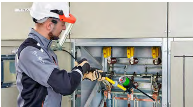
Einpoliger Phasenvergleichler PHV I an einer Schaltanlage.
