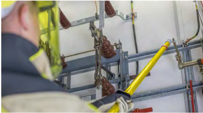
Betätigung eines Lasttrennschalters mit der Schaltstange SCS.
