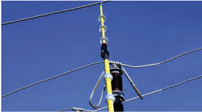
Spannungsprüfer PHE III an einer Freiluftstation 110 kV.
