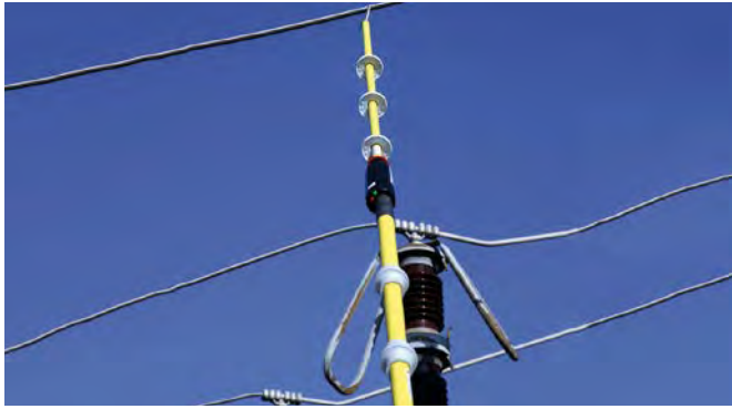
Spannungsprüfer PHE III an einer Freiluftstation 110 kV.
