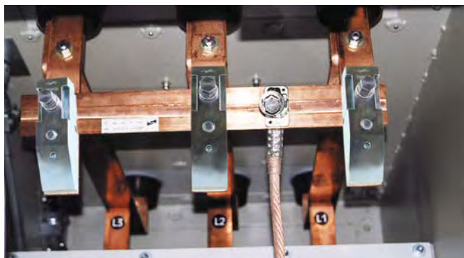
KurzschlieÙschiene mit Erdungsseil an einer Schaltanlage.
