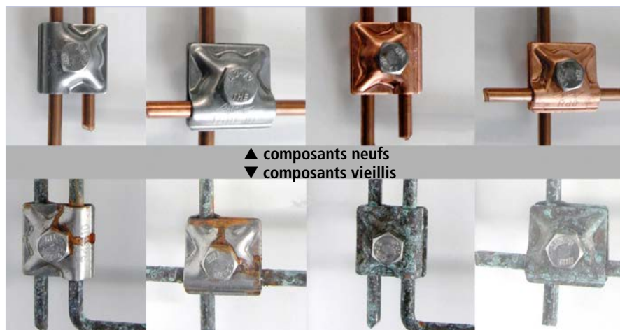
Figure 3 : composants à l'état neuf et après le vieillissement artificiel.
