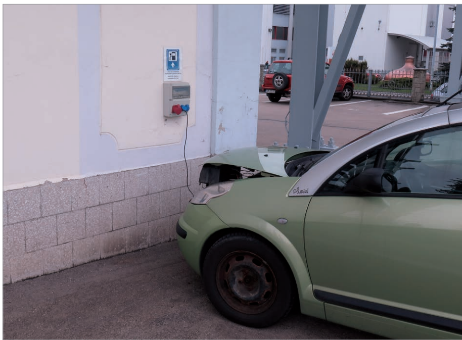
Rys. 1. Stacja ładowania pojazdów elektrycznych na ścianie budynku na parkingu w zakładzie przemysłowym
