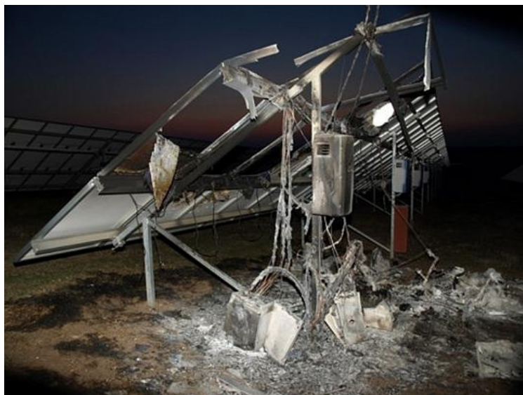
Ábra: Földre telepített napelemes rendszer károsodása villámcsapás következtében
