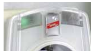
Optický ukazatel provoz/porucha na straně napájení (230 V).
