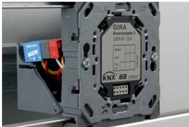
Ochrana jednotky KNX prostřednictvím svodiče BUSector. Připojení ke svorce v prostoru kabelového žlabu.
