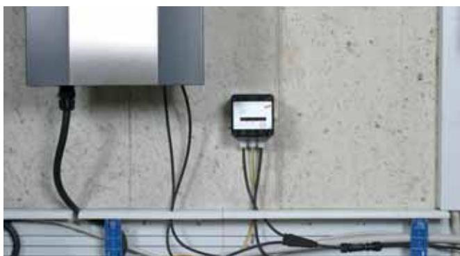
Předem připravené vedení pro jednoduché připojení příchozích stringů ke svodiči DEHNCube a střídači.
