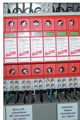
Fot. 2 Ogranicznik DEHNGuard – połączenie w „układzie V” z wykorzystaniem złączki STAK 2×16
