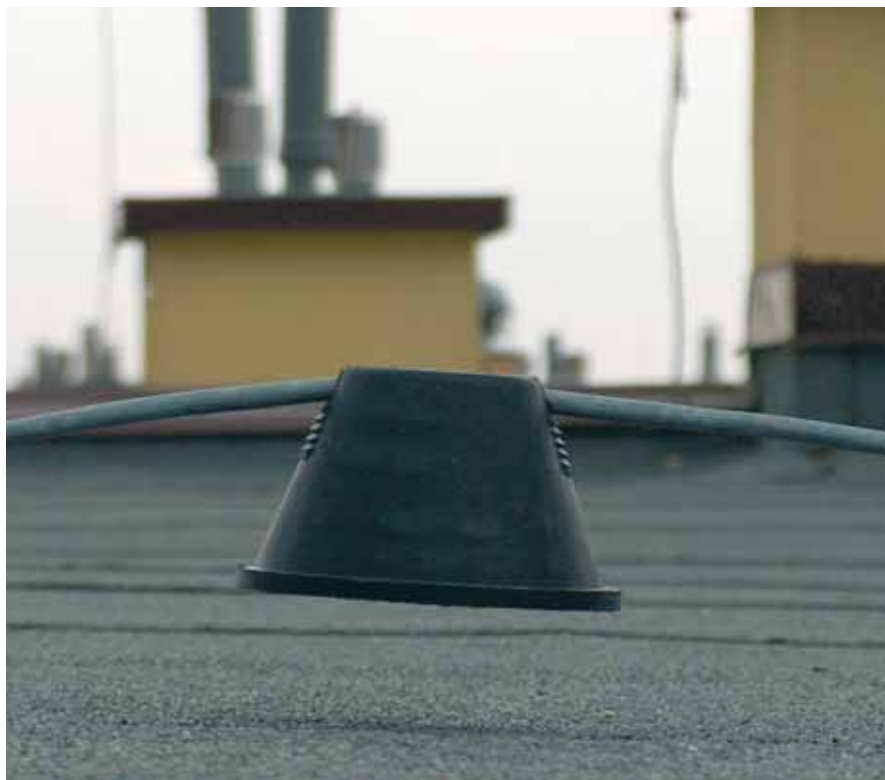
Rys. 9. Nieprawidłowa instalacja wsporników dachowych
