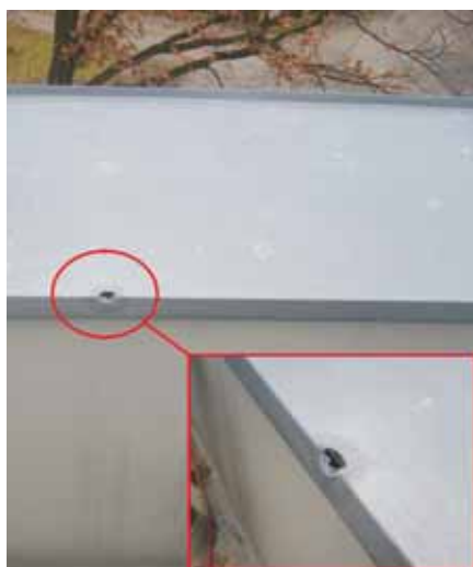
Rys. 6. Perforacja pokrycia attyki w wyniku uderzenia pioruna
