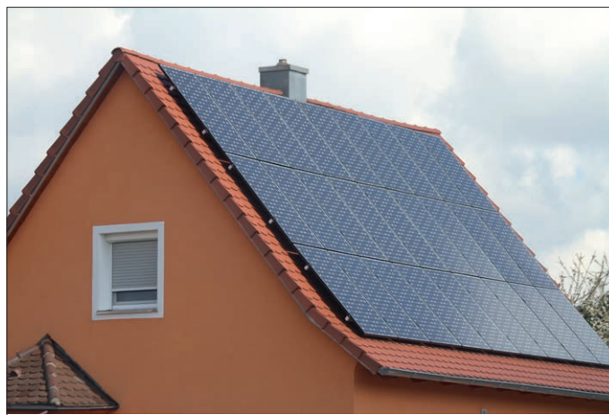
Rys. 1. Panele fotowoltaiczne na dachu budynku mieszkalnego
