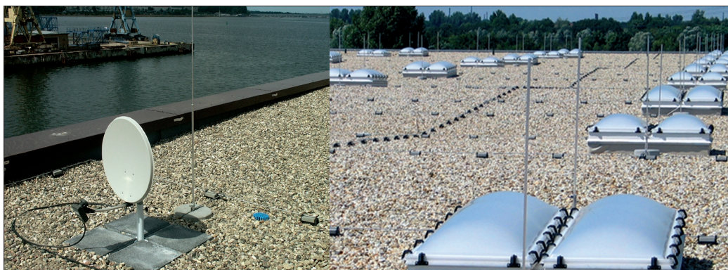
Fot. 1. Przykład wykorzystania zwodów pionowych do tworzenia przestrzeni chronionych na dachu płaskim
