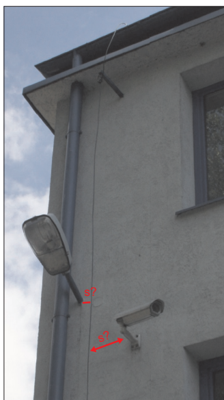
Fot. 3. Przykład instalacji kamery i oprawy oświetleniowej na ścianie budynku w pobliżu przewodu odprowadzającego
