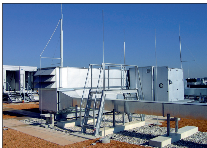
Fot. 2. Przykładowe rozwiązanie ochrony odgromowej instalacji na dachu obiektu
