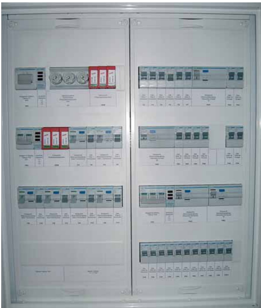
Rys. 8. Przykładowa instalacja z ogranicznikami DEHNrail 255 modular
