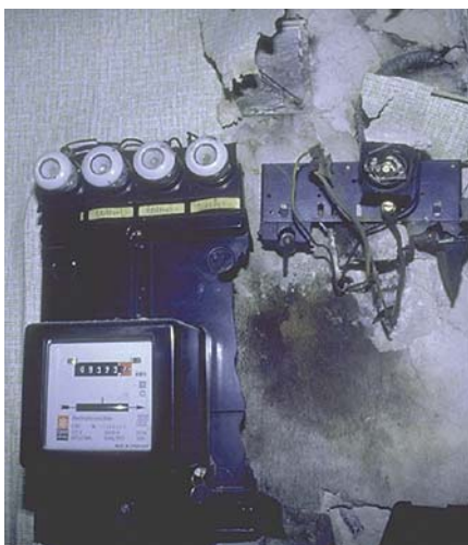
Rys. 6. Zniszczenie licznika w skutek przepięcia atmosferycznego
