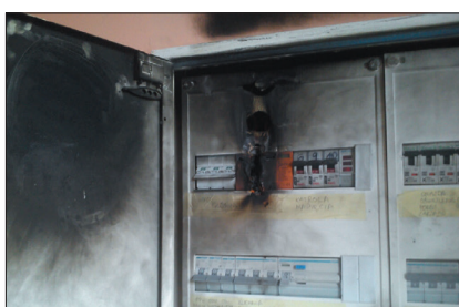
Fot. 3-4. Uszkodzona rozdzielnica niskiego napięcia z ogranicznikiem „B+C” po przepływie prądu piorunowego
