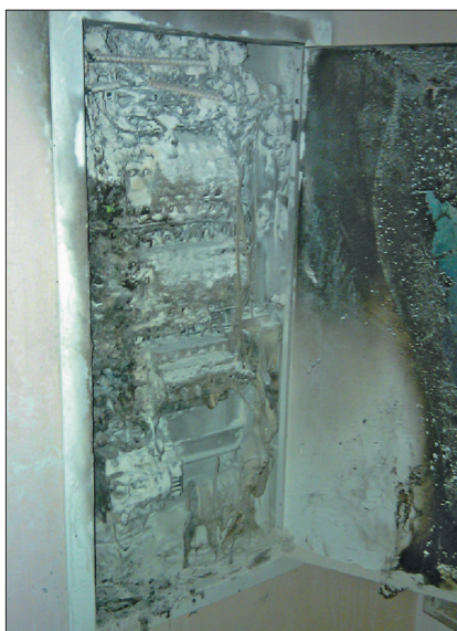
Fot. 1. Uszkodzona rozdzielnica niskiego napięcia z ogranicznikiem „B+C”
