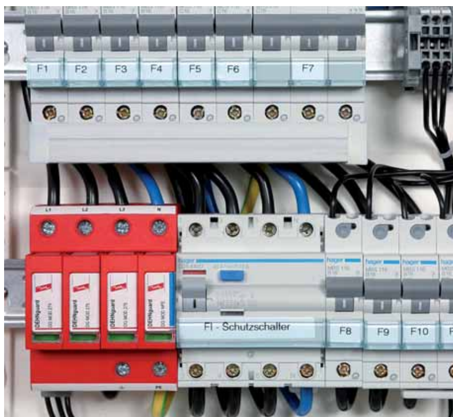
Rys. 3. Ogranicznik przepięć typ 2 DEHNGuard M TT zainstalowany w rozdzielni
