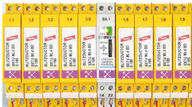
Unità DEHNrecord Condition Monitoring installata.
