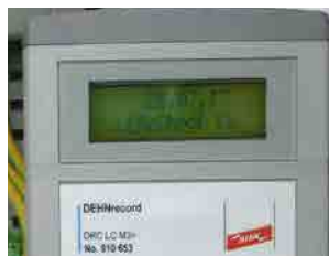
Verifica dell'intervallo con DRC LC M3+.
