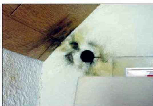
Přeskok blesku po vnitřní stěně pokoje
