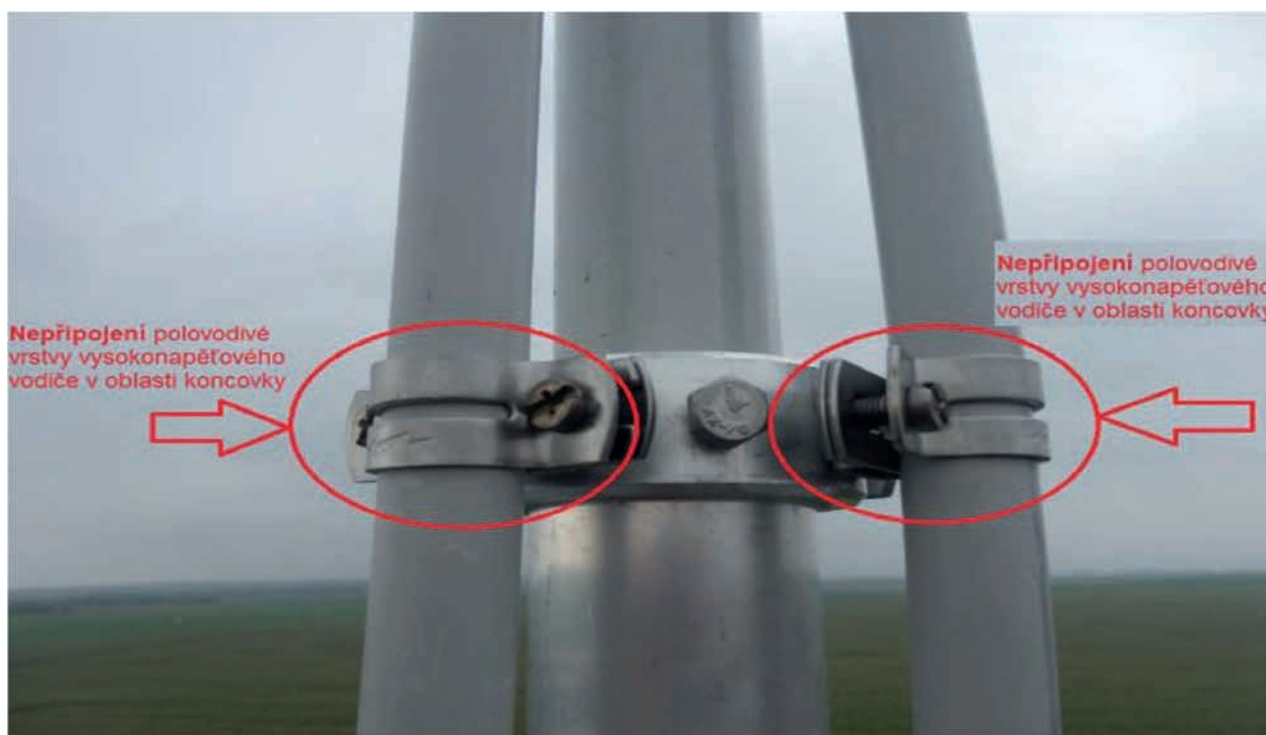
Ukázka chybné instalace – nedodržení montážního návodu
