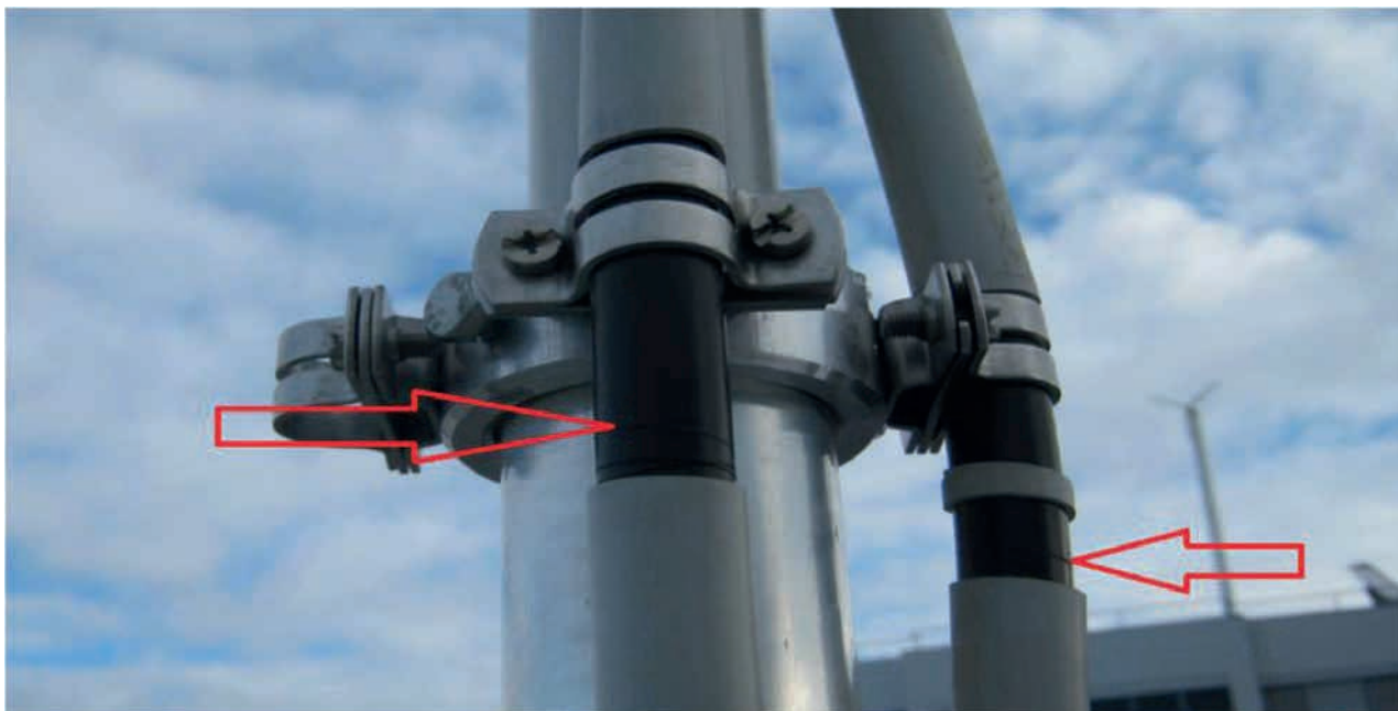
Ukázka poškození vodiče během instalace
