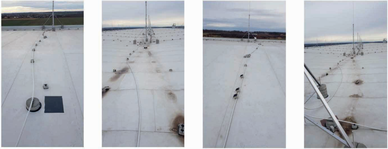
Ukázka poškození jímací soustavy po silném větru
