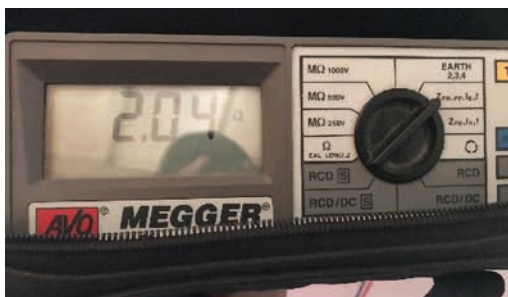
Obr. 10. Naměřená hodnota uzemnění
